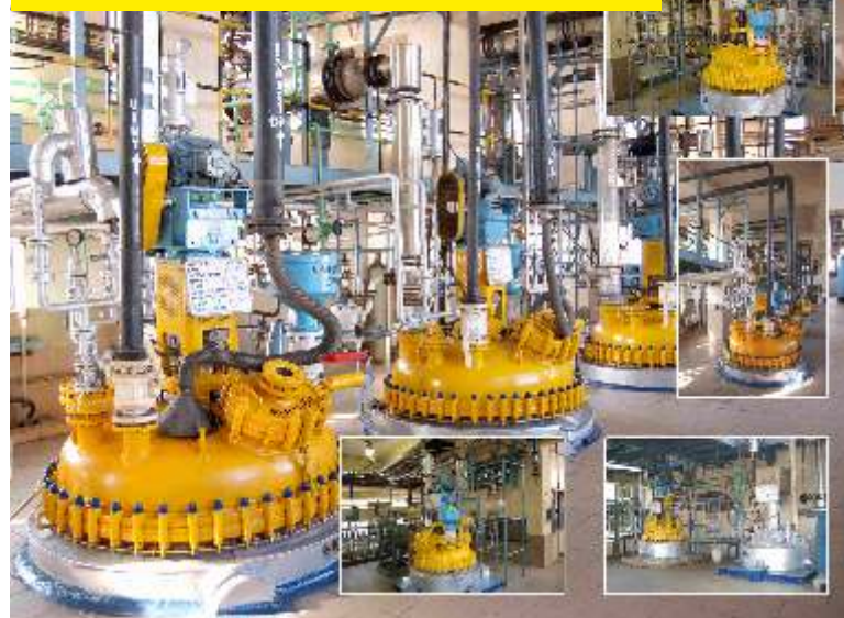
Reactores con revestimiento de vidrio
